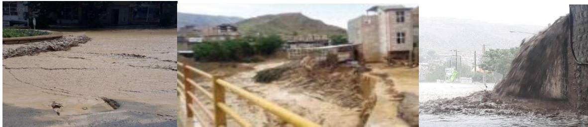
شکل ۳. سیلاب مورخ ۱۳۹۸/۲/۲۸ - ۲۶، آب‌گرفتگی و تخریب منازل در شهر کلات
